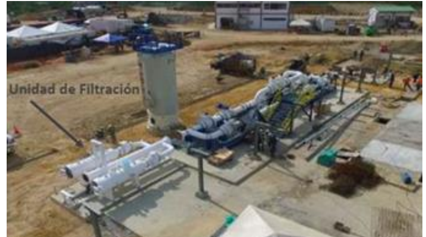
Instalación de unidades de medición y filtración – Agosto de 2016
